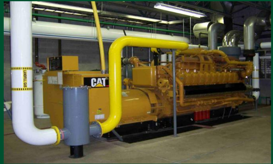
CAT 3520 Landfill Gas Generator
